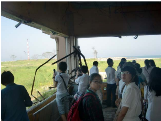
8月21日 被災地視察（山元町） 中浜小学校・校舎内 8月21日視察灾区（山元町） 山元町中浜小学旧校舍、校舎内
